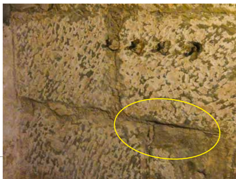
Maladie de la pierre attaquant le grès des bâtiments du Pavillonweg.
